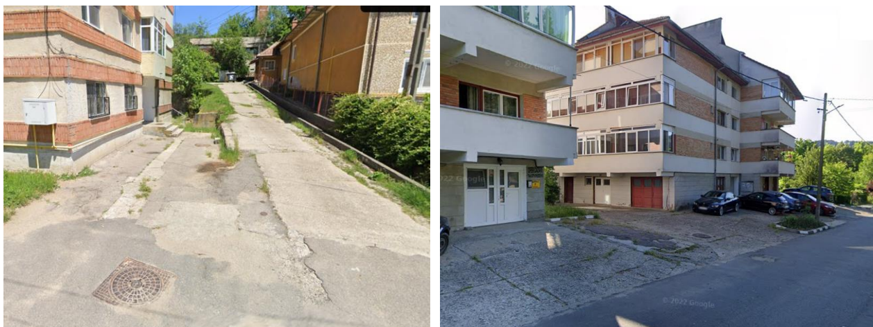
Figura 2.51. Spații publice în stare necorespunzătoare (exemplificare).
